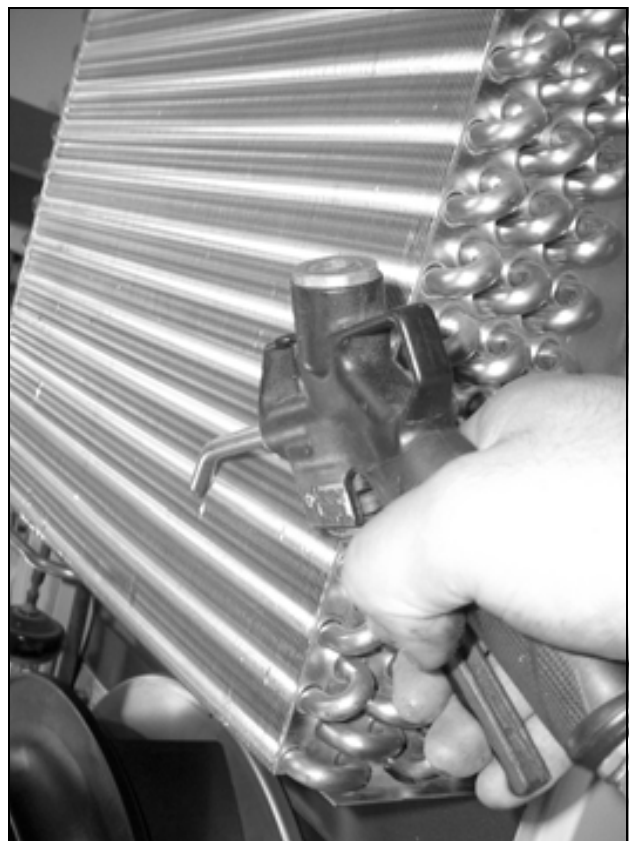
Kuva 58: Puhalla lämmönvaihtimen kenno ja kompressoritila paineilmalla (1)
