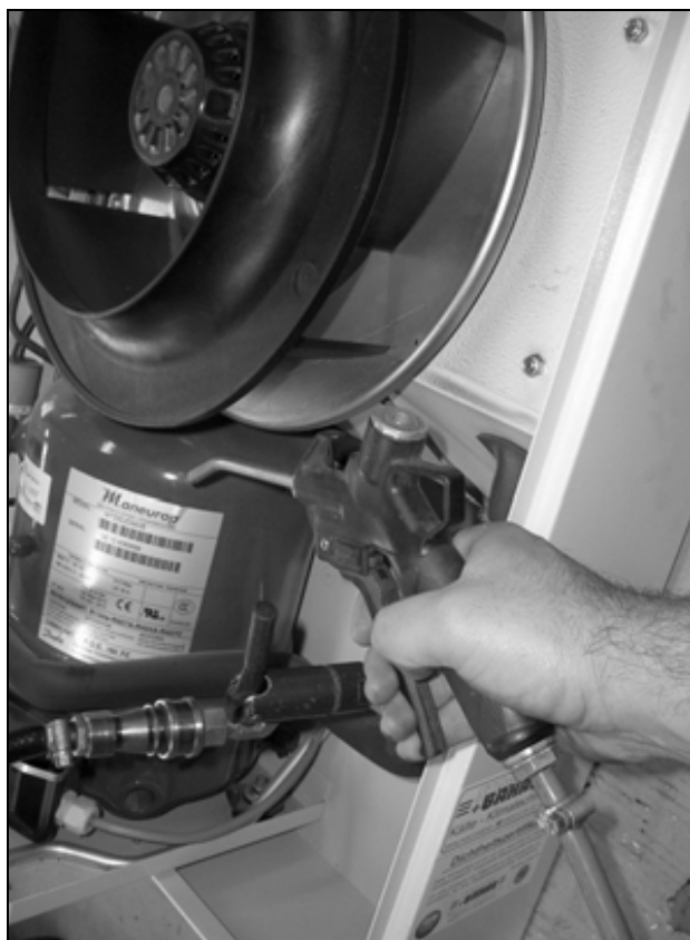
Kuva 83: Puhalla lämmönvaihtimen kenno ja kompressoritila paineilmalla (3)
