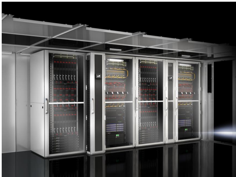
Abbildung 2: Rack – und Reihenklimatechnik in einer Gangschottung
