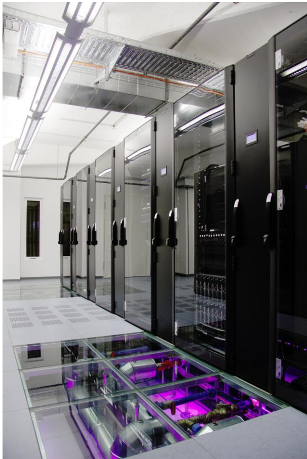
Abbildung 1: Rackklimatisierung mit LCP
