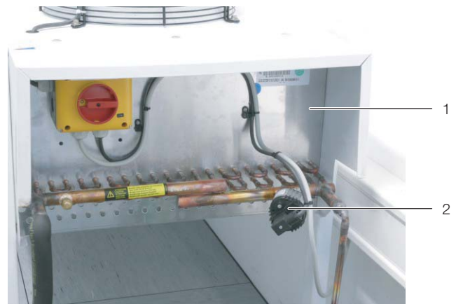
Рис. 31: Выключатель на конденсаторе
