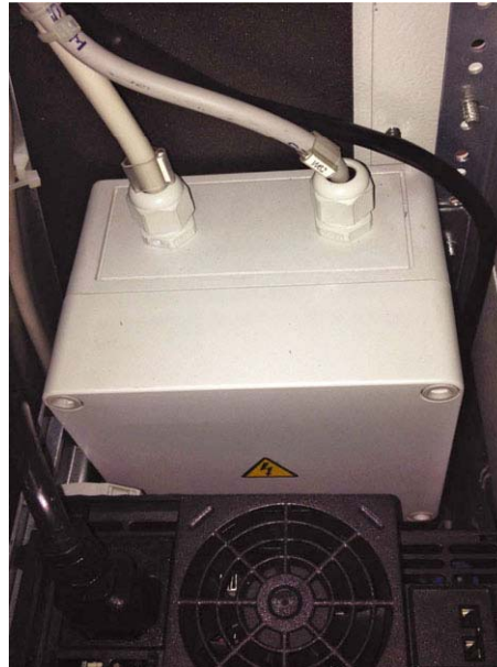
Рис. 54: Дополнительный бокс для предохранителей электрического обогревателя
