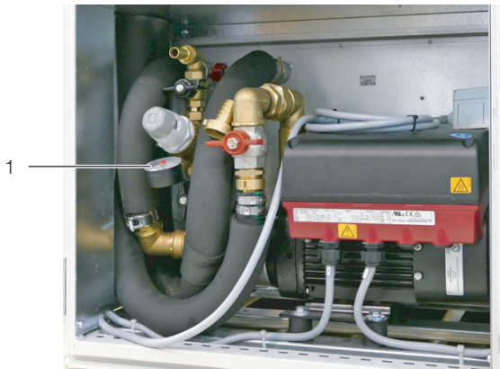
Abb. 48: Manometer im Wasserkreislauf
