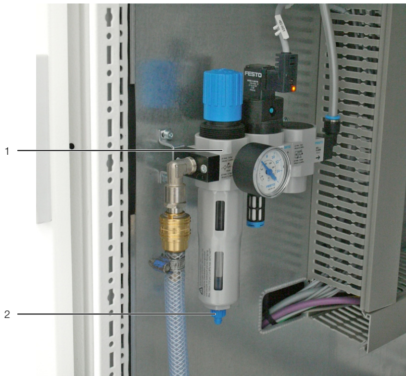
Obr. 34: Jednotka pro úpravu stlačeného vzduchu
