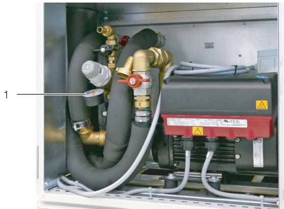
Abb. 48: Manometer im Wasserkreislauf
