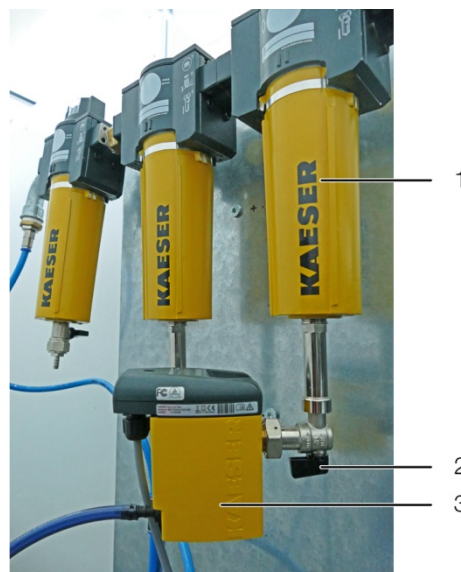
Abb. 43: Druckluft-Filter (Rückseite des Kompressors)
