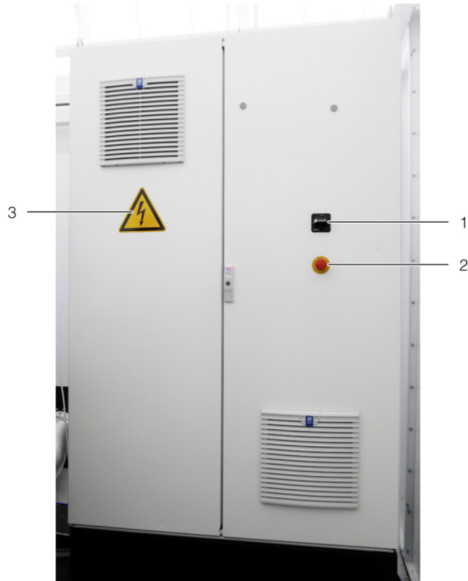
Abb. 12: Bedienelemente am Schaltschrank
