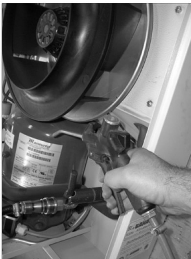
图57：用压缩空气清吹热交换器盘管和压缩机室 (2)
