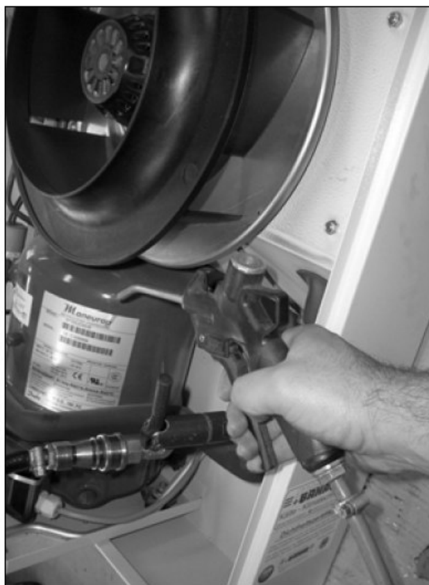
图81: 用压缩空气清吹热交换器盘管和压缩机室 (3)
