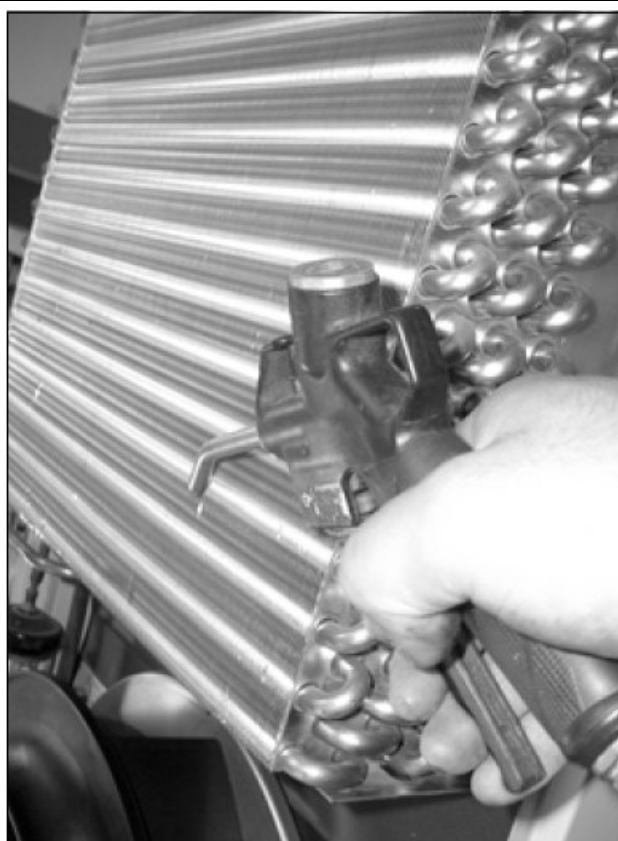
图80: 用压缩空气清吹热交换器盘管和压缩机室 (2)
