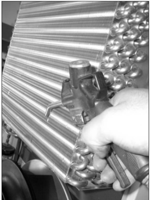
图56: 用压缩空气清吹热交换器盘管和压缩机室 (1)
