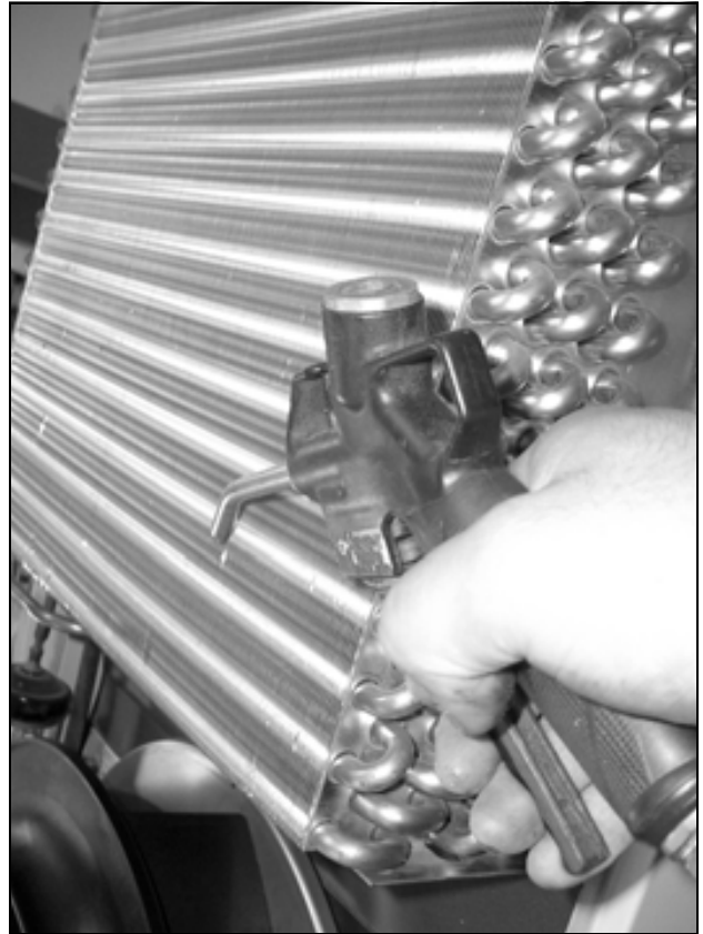
Abb. 80: Wärmetauschregister und Kompressorraum mit Druckluft ausblasen (2)
