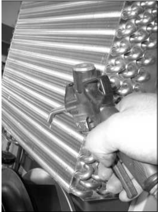
Afb. 79: Warmtewisselaarregister en compressoruimte met perslucht doorblazen (2)
