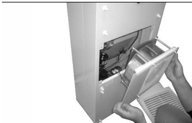
Afb. 68: Ventilator extern circuit uitbouwen
