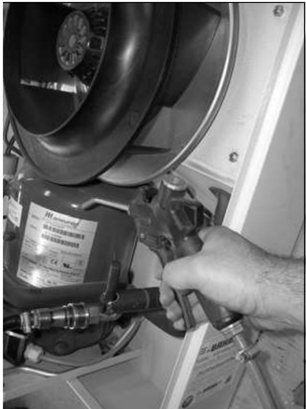
Afb. 80: Warmtewisselaarregister en compressoruimte met perslucht doorblazen (3)
