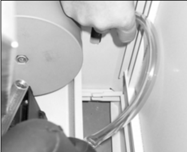
Bild 9: Kondensavloppet leds ut ur aggregatet
