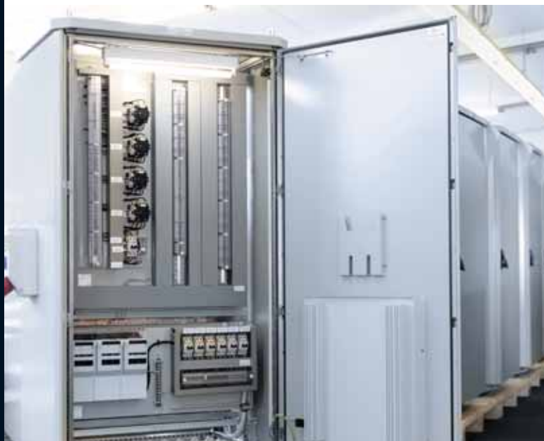
La produzione e la distribuzione della quadristica e dei moduli funzionali sono interamente gestite da SSS Elektrotechnische Systeme, Assia, che svolge la funzione di fornitore unico.
