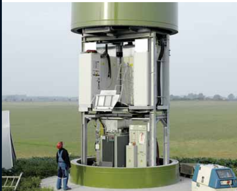
Enercon utilizza gli armadi TS8 Rittal per l'installazione degli inverter delle sue turbine eoliche.
