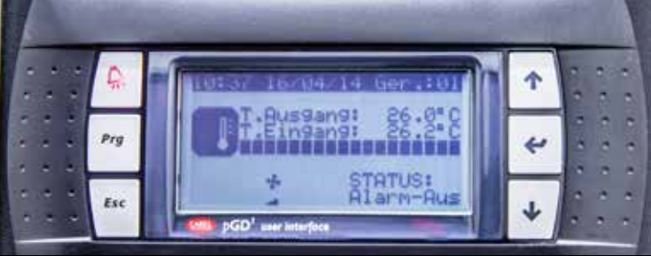
Klima-Steuerung: Die warme Luft des IT-Equipment wird aus dem Gang an der Geräterückseite des LCP DX angesaugt, über das Hochleistungs-Kompaktregister abgekühlt und wieder kalt in den Raum oder Kaltgang eingeblasen.
