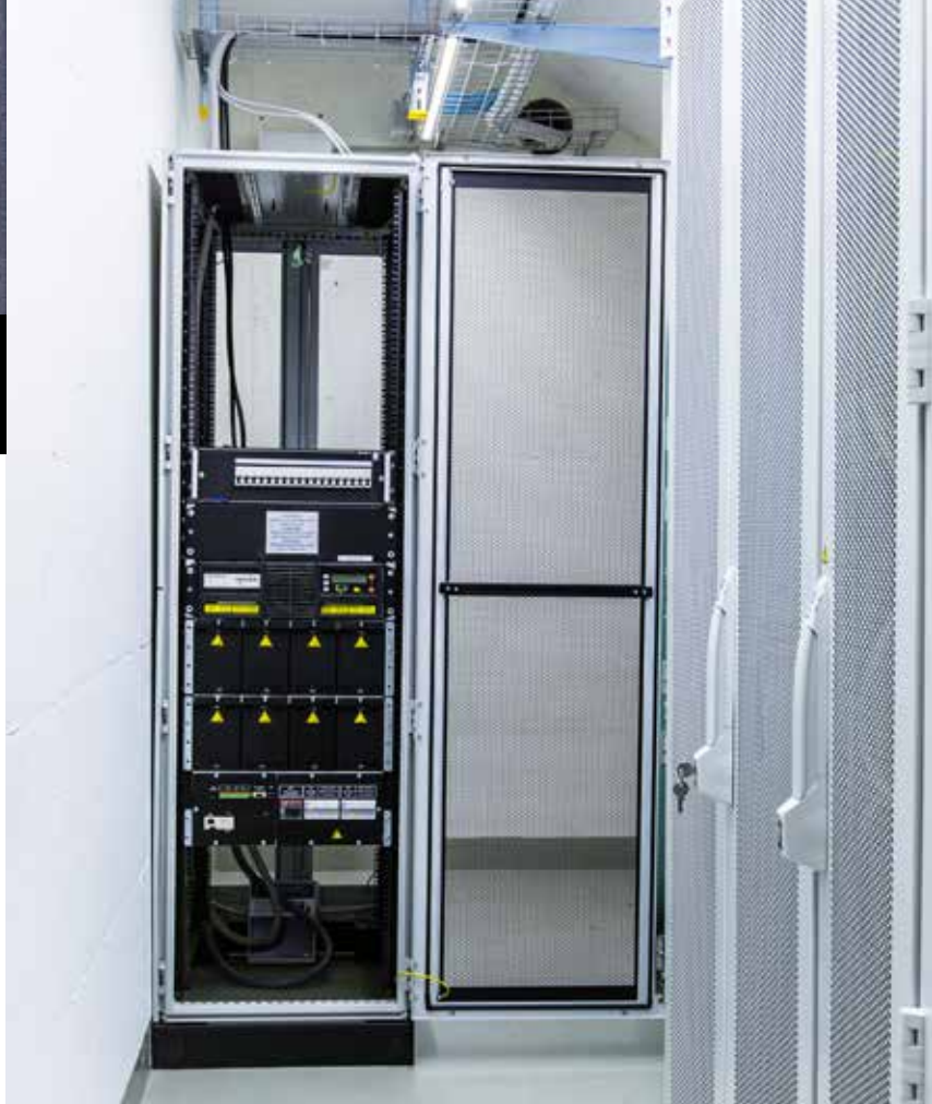
USV mit Batteriepaket mit Doppelwandler-Technologie nach der höchsten Klassifizierung VFI-SS-111 und integrierter 19" Unterverteilung, zur Anbindung der PSM-Schienen mit Messung.
