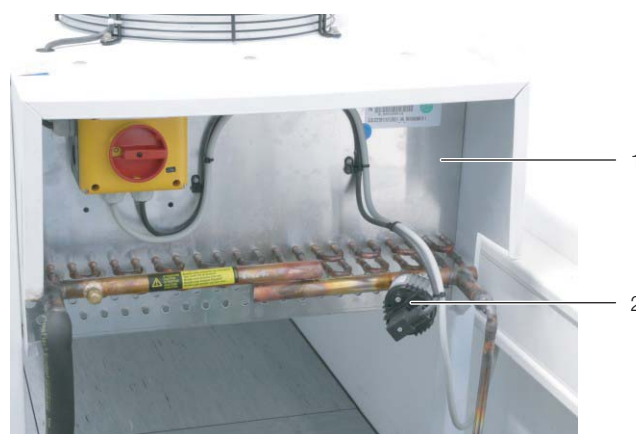
Рис. 31: Выключатель на конденсаторе
