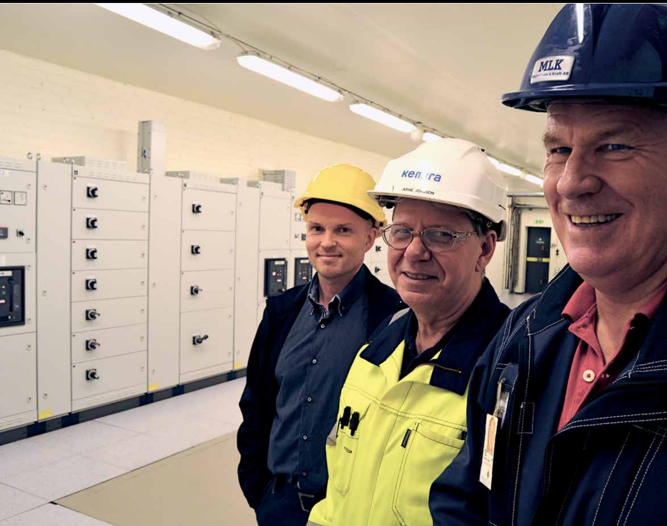
Björn Sjödin, projektansvarig på Rittal Scandinavian, Arne Jönsson, elingenjör på Kemira Kemi och ansvarig för energiförsörjningen, och Stefan Nilsson på Malmö Ljus & Kraft AB, är nöjda med det nya konceptet för Kemira Kemis ställverksrum som hämtat inspiration från moderna datorhallar.
