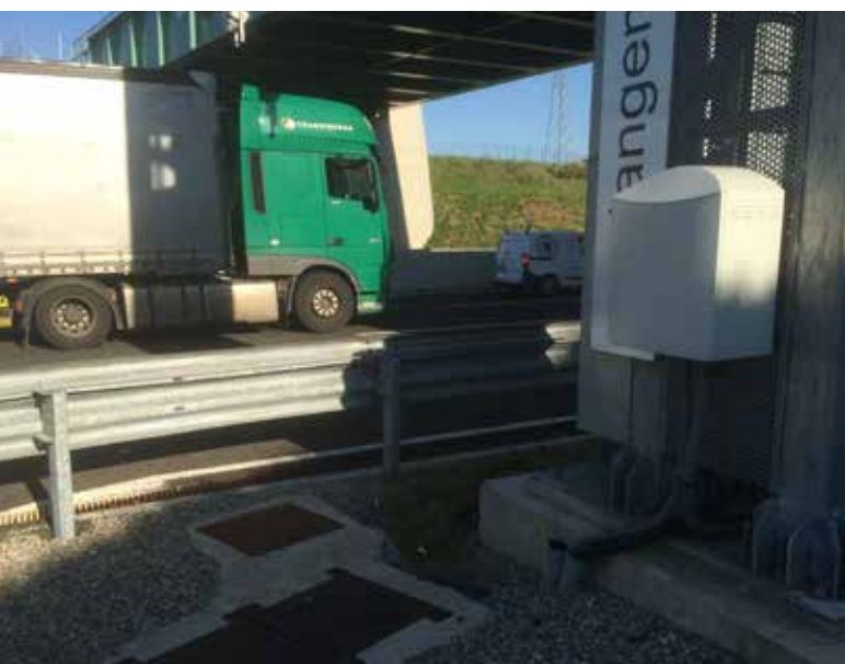
CS Wall-Mounted che ospita la soluzione SICVE su tratta autostradale
