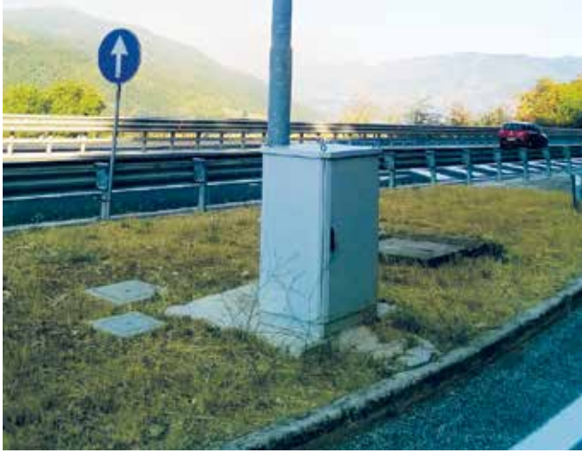
Cabinet speciale per l'alloggiamento dei sistemi di controllo area di sosta autostradale
