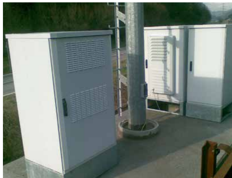
CS Toptec per il contenimento delle apparecchiature necessarie al monitoraggio della terza corsia dinamica
