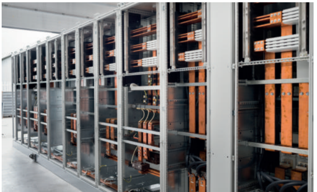
De oplossing van Werkina zorgt voor een optimale stroomverdeling en de Rittal TS 8 kasten met het Rittal Ri4Power railsysteem maken een compacte indeling mogelijk.
