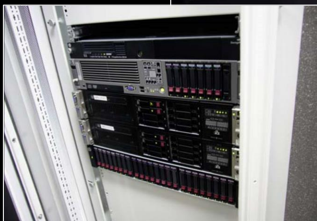
Systemy IT klienta zainstalowane w 19" racku
