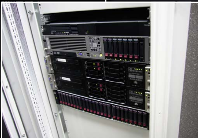
IT-Systeme des Kunden, eingebaut im 19"-Server-Rack
