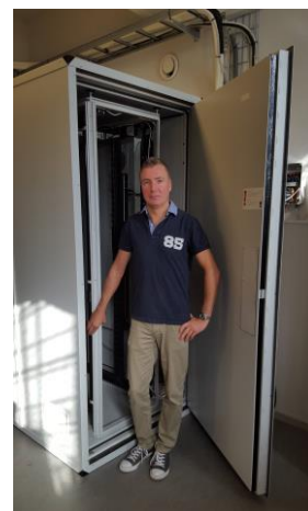
Søfartsstyrelsen valgte af øge IT-sikkerheden. Robert Gideland, forvaltningsleder for tekniske platforme er yderst tilfreds med det nye Micro Data Center fra Rittal.
