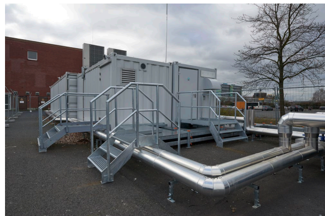
Höchst Cloud Park i Frankfurt-regionen är ett exempel på ett datacenter för företag som frågar efter Industri 4.0 applikationer och Edge-scenarier med korta latenstider. IT-resurser kan skapas snabbt och säkert tack vare nyckelfärdiga IT-containrar från Rittal.
