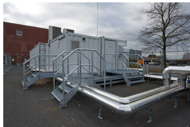
Höchst Cloud Park i Frankfurt-regionen er et eksempel på et datacenter for virksomheder som efterspørger Industri 4.0 applikationer og Edge-scenarier med korte latenstider. IT-ressourcer kan skabes hurtigt og sikkert takket være nøglefærdige IT-containerne fra Rittal.
