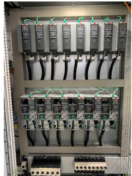
Billede 1: Rittal styreskab med frekvensomformere og Rittal skinnesystem.
