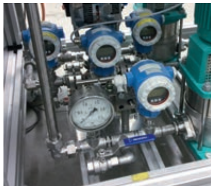
Neben den digitalen Messgeräten von Endress+Hauser sind auch mechanische Manometer und Magnetklappenanzeiger des Herstellers Wika installiert.
