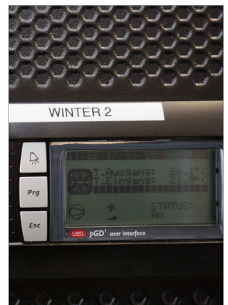
Im Winter wird die Abwärme zum Heizen der Werkshalle genutzt.
