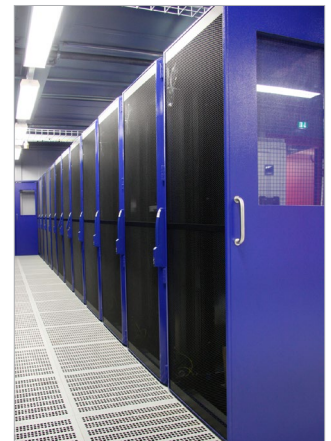
Das Rechenzentrum erfüllt höchste Sicherheitsstandards.
