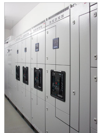
Die NSHV entstand auf Basis des Rittal Ri4Power Systems.
