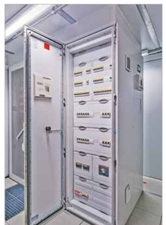
RiMatrix S enthält alles, was ein komplettes Rechenzentrum braucht.
