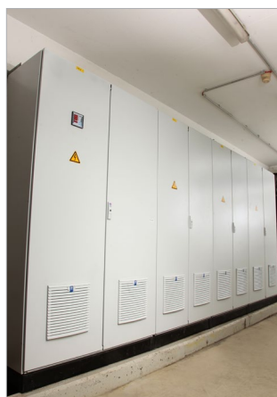
Die neue Anlage umfasst vier Felder mit nur 4,40 m Länge.
