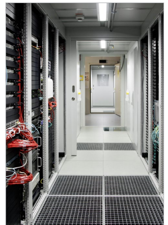
Die Installation von RiMatrix S erfolgte als Raum-in-Raum-Lösung.
