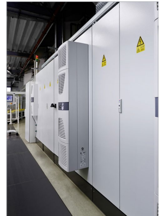
Eine Feldstudie hat Schwächen in der Klimatisierung von Schaltschränken aufgedeckt.
