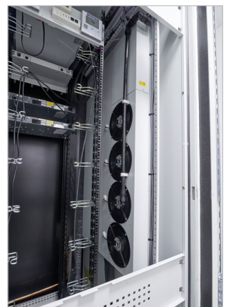
Die Kühlung der Serverschränke erfolgt über das integrierte Split-Klimagerät LCU DX.
