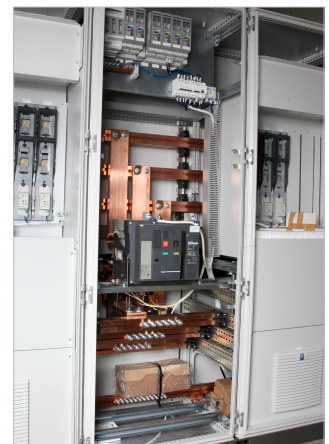
Den Aufbau der Stromverteilung für Dubai hat Rittal übernommen.
