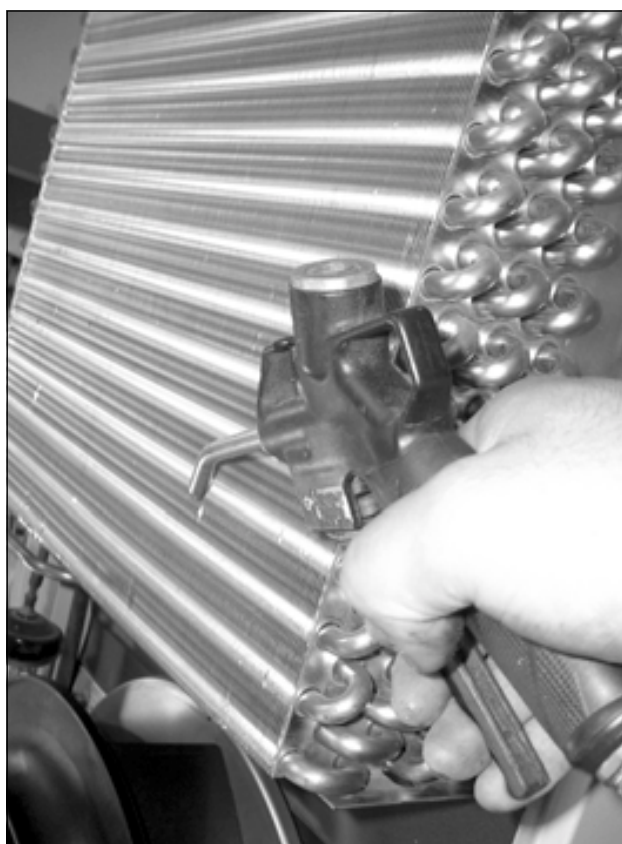
Abb. 58: Wärmetauschregister und Kompressorraum mit Druckluft ausblasen (1)
