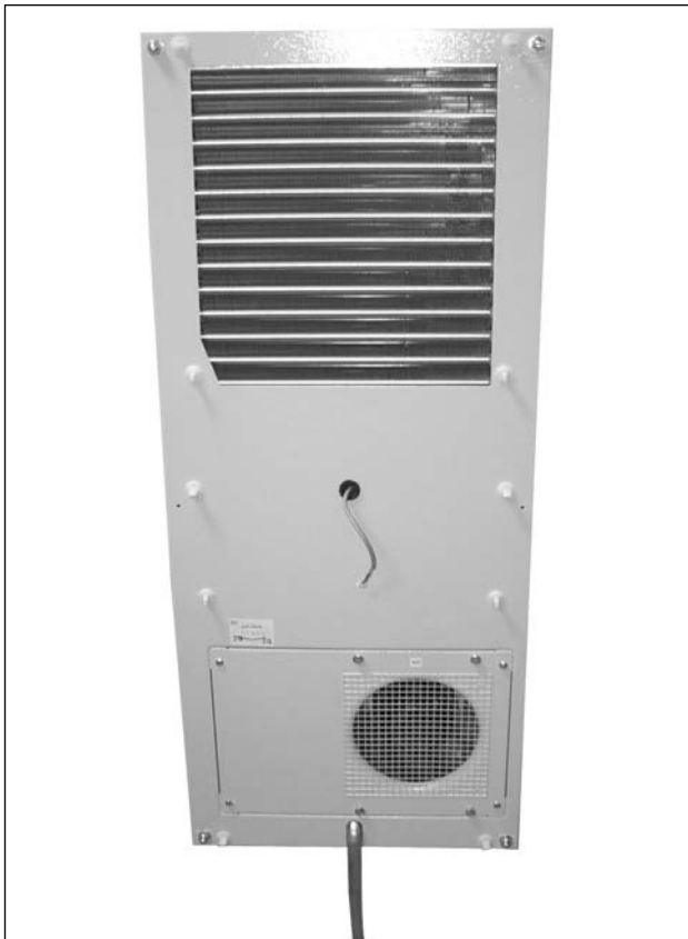
図 47：ルーバーを外したーリングユニットの様子
