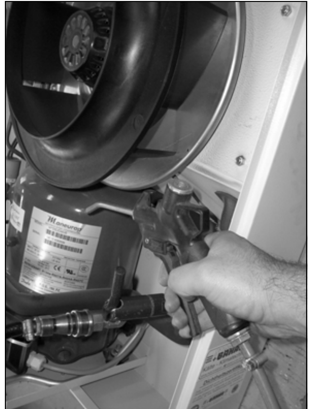
Fig. 52 : nettoyer l'unité d'échange thermique et l'espace compresseur à l'air comprimé (2)
