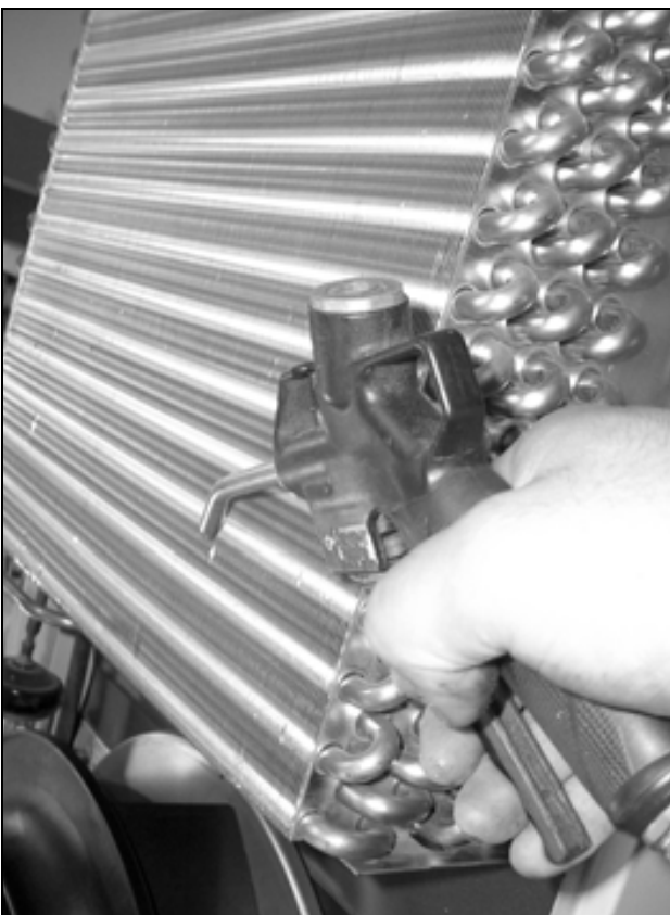
Fig. 51 : nettoyer l'unité d'échange thermique et l'espace compresseur à l'air comprimé (1)
