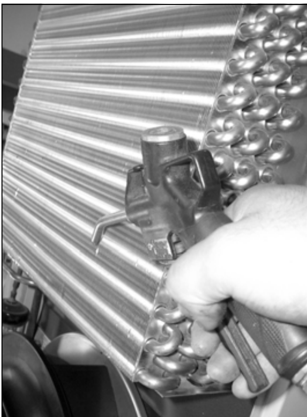
Fig. 75 : nettoyer l'unité d'échange thermique et l'espace compresseur à l'air comprimé (2)
