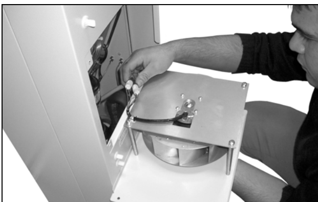
Fig. 65 : débrancher les fiches de raccordement du ventilateur (1)
