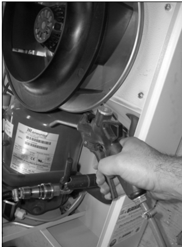
Fig. 76 : nettoyer l'unité d'échange thermique et l'espace compresseur à l'air comprimé (3)
