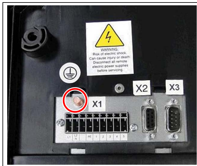
Rys. 13: Złącze wyrównania potencjałów
