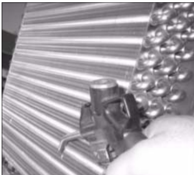
Kuva 40: Puhalla lämmönvaihtimen kenno ja kompressoritila paineilmalla
