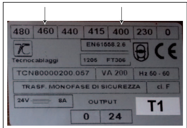
Fig. 9 : raccordement du transformateur
