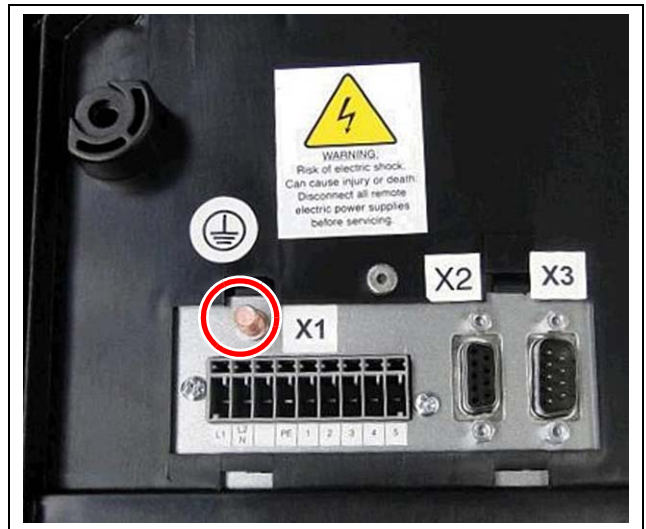
Imagen 13: Punto de conexión, compensación de potencial
