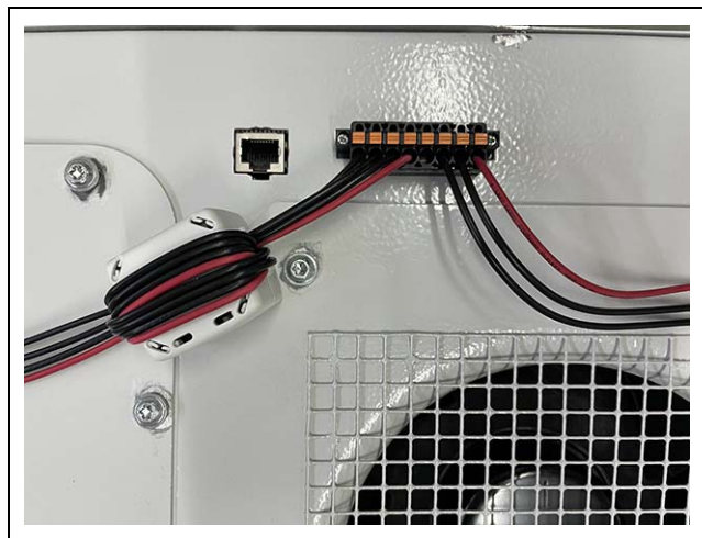
Obr. 10: Signální kabel s namontovaným feritovým jádrem
