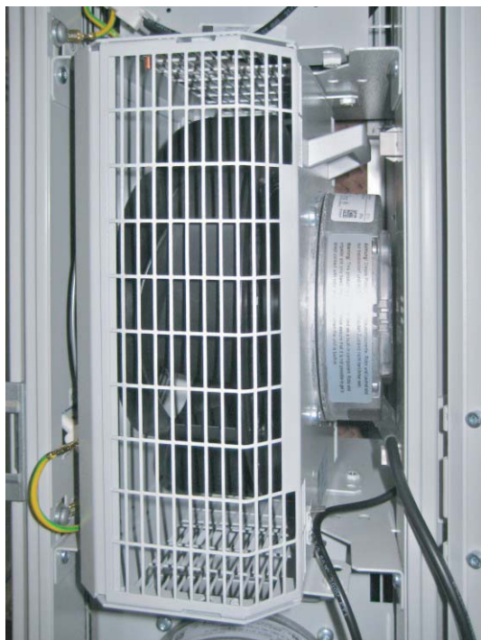
Рис. 31: Повернутый вентиляторный модуль в модульном отсеке – исполнение у LCP Inline и LCP Rack
