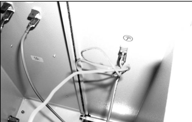
Bild 68: Dra ut fläktens jordkabel (1)
