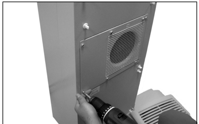
Bild 63: Loss de fyra skruvarna på ytterkretsens fläkt
