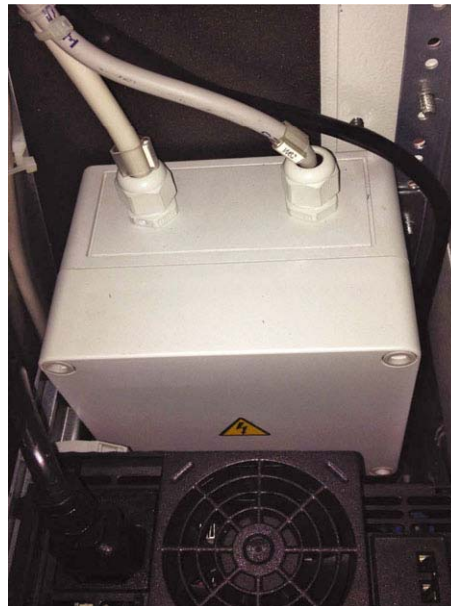
Abb. 55: Zusätzliche Box für die Thermosicherungen der elektrischen Heizer
