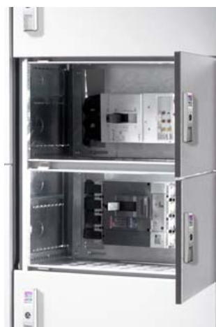
Přípojnice za funkčním prostorem
