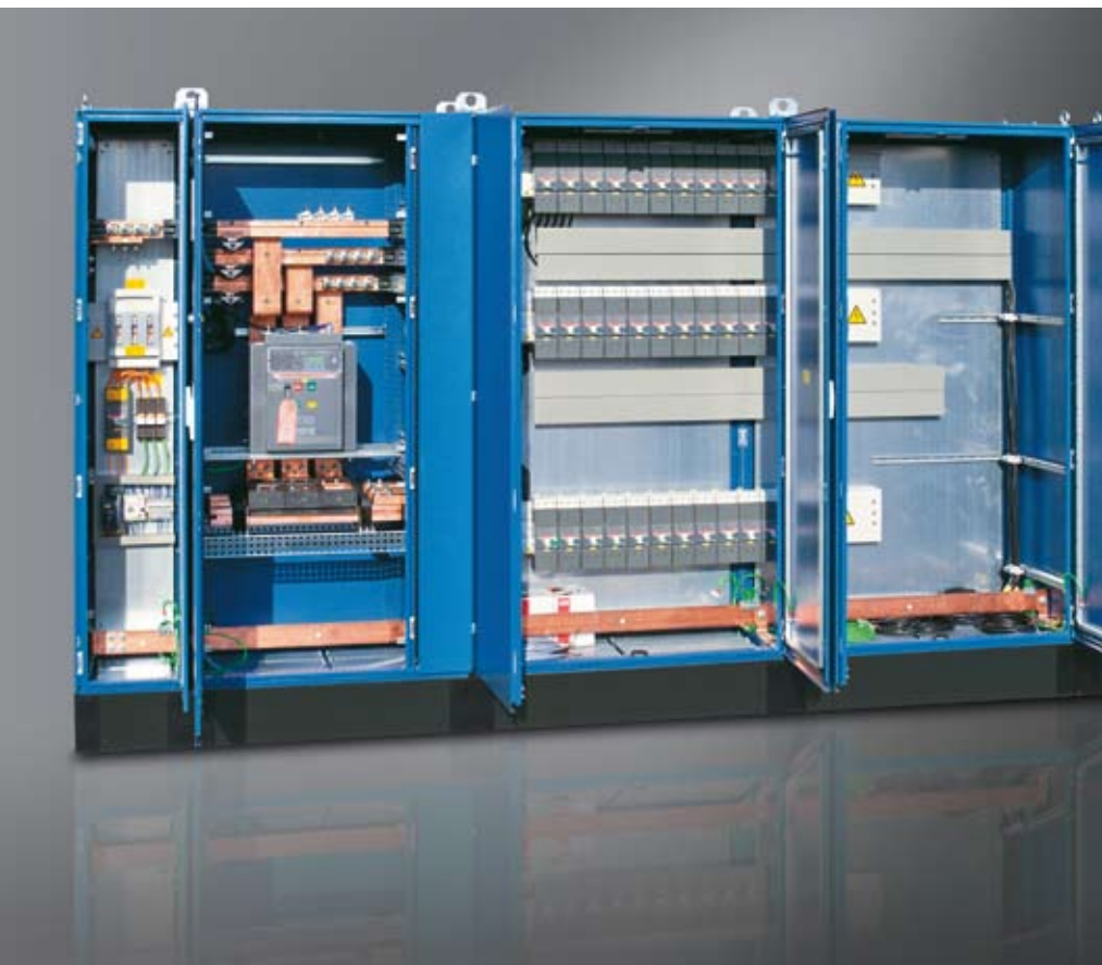
Geplant mit Power Engineering: Ausschnitt einer Niederspannungsschaltanlage im UL-Aufbau für eine Druckmaschine, ausgeführt durch die Trips GmbH mit Rittal Stromverteilungskomponenten RiLine60 cULus-listed und Maxi-PLS.
