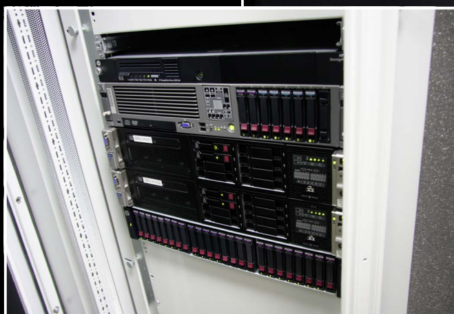
IT-системы клиента, установленные в 19" серверную стойку
