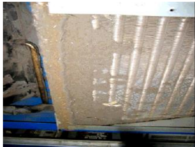
Загрязненный теплообменник конденсатора
