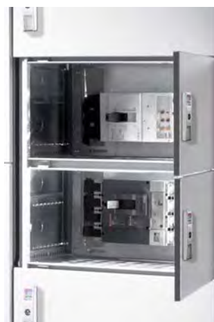
Szyna zbiorcza prowadzona za przestrzenią funkcyjną
