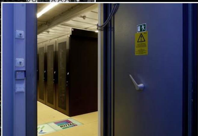
Drzwi zabezpieczające mającego certyfikat ECB-S pomieszczenia o wysokiej dostępności
