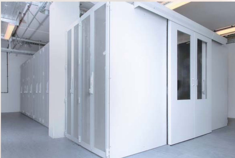
In 14 Rittal TS IT Racks haben die Server von Manner Platz gefunden, aufgestellt in zwei gegenüberliegenden Reihen bilden sie den Kaltgang.
